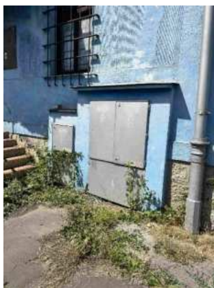
Elektromer na verande
