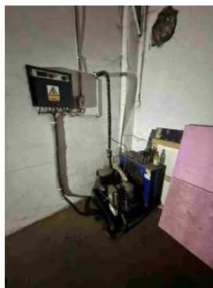
1.NP – el. rozvádzač
